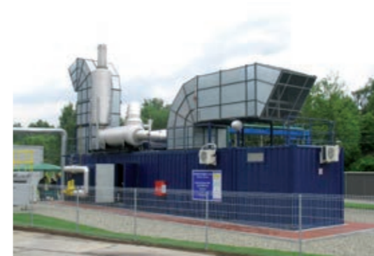
Bergwerke KWK, Sosnica, Polen Installierte elektrische Leistung: 4 MW Anzahl der Blockheizkraftwerke: 2 Baujahr: 2009
