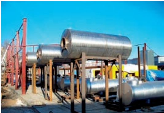
Fernheizanlage Chimky, Moskau, RU Installierte elektrische Leistung: 16 MW Anzahl der Blockheizkraftwerke: 8 Baujahr: 2008
