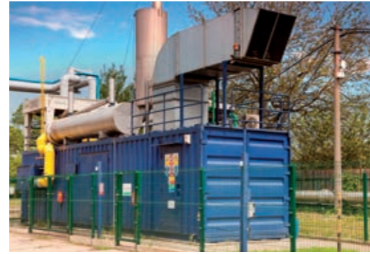
Bergwerke Green Gas DPB, CZ Installierte elektrische Leistung: 28,1 MW Anzahl der Blockheizkraftwerke: 21 Baujahr: 2010
