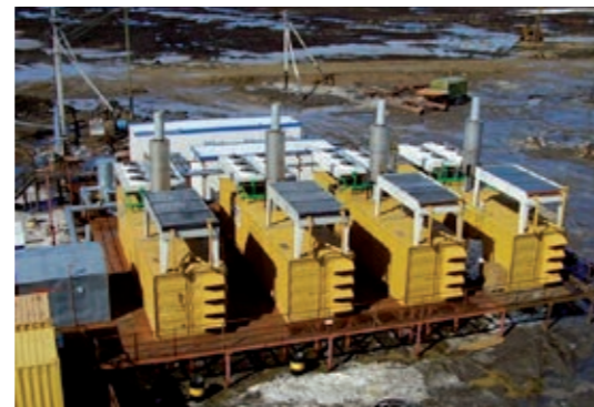
Ölfeld, Petchoraneft, Russland Installierte elektrische Leistung: 5,8 MW Anzahl der Blockheizkraftwerke: 5 Baujahr: 2003 - 2006
