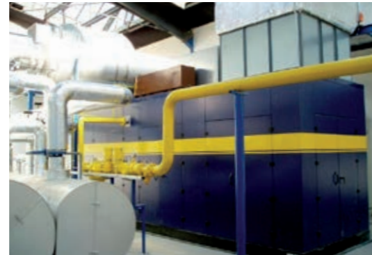
Fernheizanlagen der MVV Energie, CZ Installierte elektrische Leistung: 13,4 MW Anzahl der Blockheizkraftwerke: 9 Baujahr: 2009
