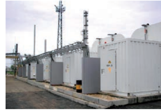
Raffinerie, Petroil, Russland Installierte elektrische Leistung: 10 MW Anzahl der Blockheizkraftwerke: 5 Baujahr: 2005
