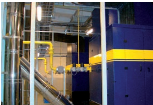
Fernheizanlage, Pass, Polen Installierte elektrische Leistung: 3 MW Anzahl der Blockheizkraftwerke: 3 Baujahr: 2008
