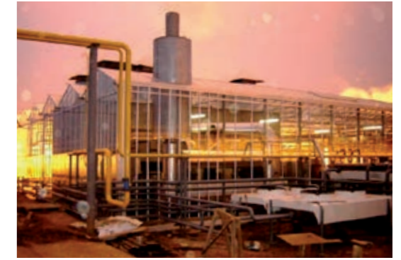
Treibhäuser, Rosengarten, Russland Installierte elektrische Leistung: 23 MW Anzahl der Blockheizkraftwerke: 12 Baujahr: 2005 - 2008
